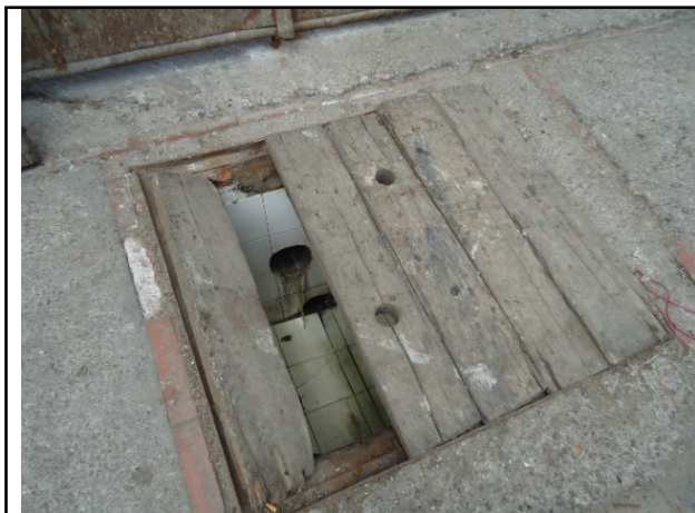
Foto 5. Caja de inspección externa
